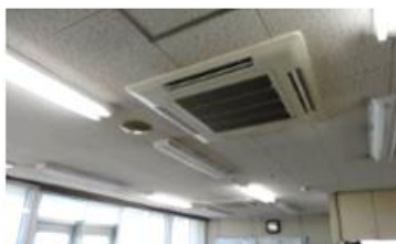
更新後の照明と空調
