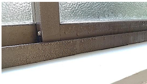
工場の窓の結露
