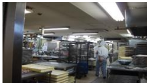
既存の空調設備
