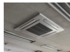
導入後の空調設備
