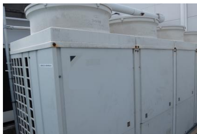
既存の空調設備
