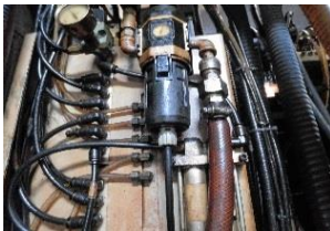
空気漏れ箇所
