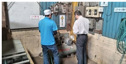
省エネ診断(コンプレッサーの調査)
