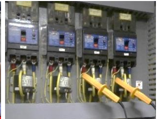
電力計測状況
