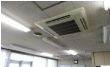
更新後の照明と空調
