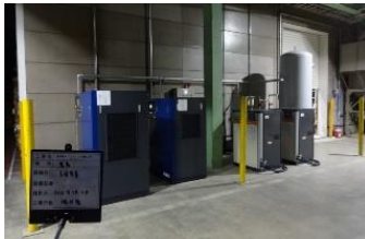
コンプレッサ(更新後)
