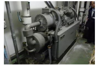
更新前の老朽化した水冷チラー
