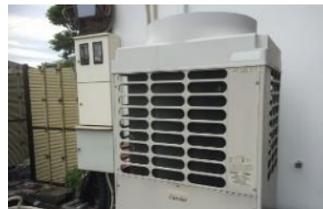
既存の空調設備
