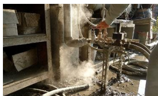
蒸気漏れ 対策前
