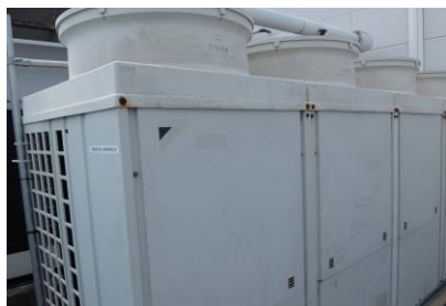
既存の空調設備
