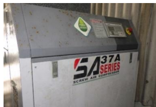
エアコンプレッサー
