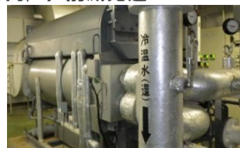
ガス焚吸収冷温水機
