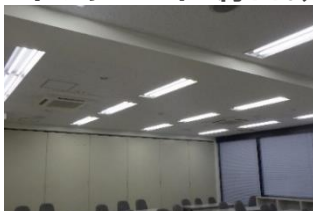
空調機及び照明設備
