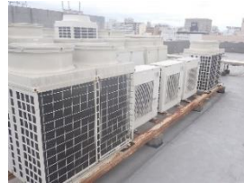
老朽化した空調設備
