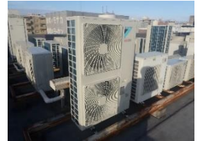
高効率空調設備
