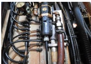
空気漏れ箇所
